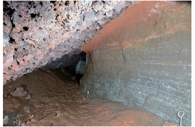
隧道内現況 (出口より 28m・土石流堆積状況) 東から
