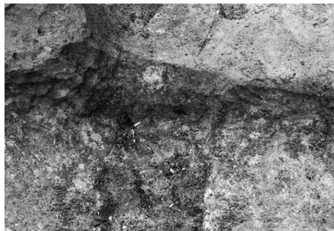
4 同・通風孔赤化状態、東から
