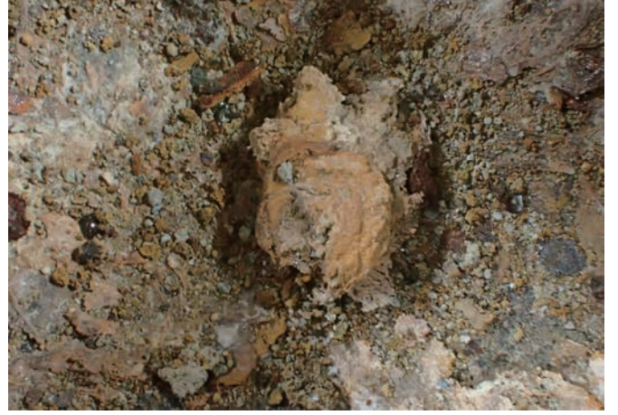
写真339 鉢内面に突き出た鉄管のアップ
