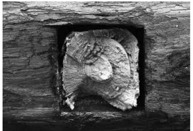
4 槽場男柱、底部近く貫の様子
