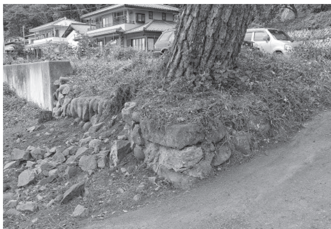
2 尋常小学校跡地 南辺石垣 崩落状況 南東から
