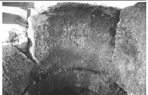
7 井戸枠（上段）内面 風化が著しく、石材の割れが目立つ
