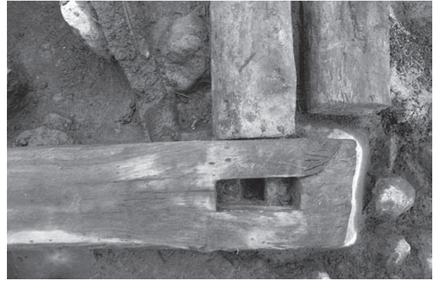
写真7 南西隅の土台隅の納まり。平柄が差され、隅柱の重柄に対応するため、二段に穴が刻まれている。
