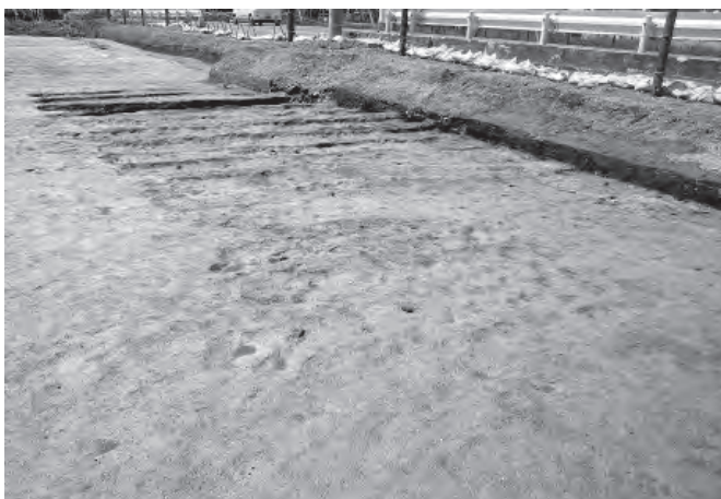
20号復旧痕 全景 北から
