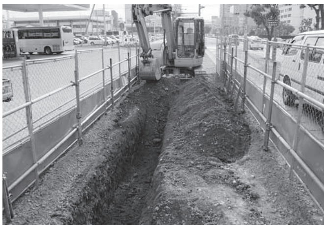
22区 攪乱状況 (東から)
