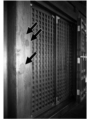
図3 北西隅の柱（西面） 吉田氏が以前指摘した橋掛かり取付きの痕
