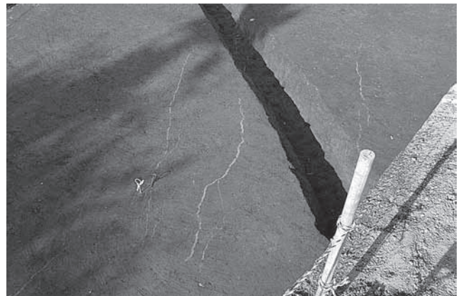
噴砂痕（2区、南より）
