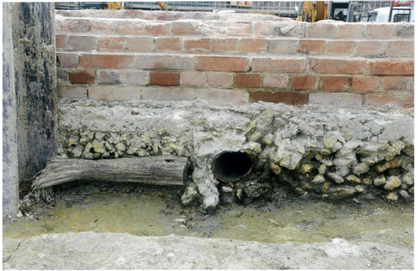
3号遺構排水口 北東より コンクリート基礎より数cm出ている。木材は型枠？
