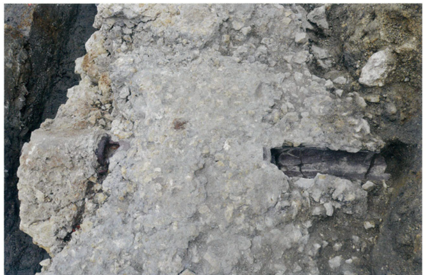
排水溝（陶管）西より レンガ積み基礎下の陶管はコンクリートで覆われている。
