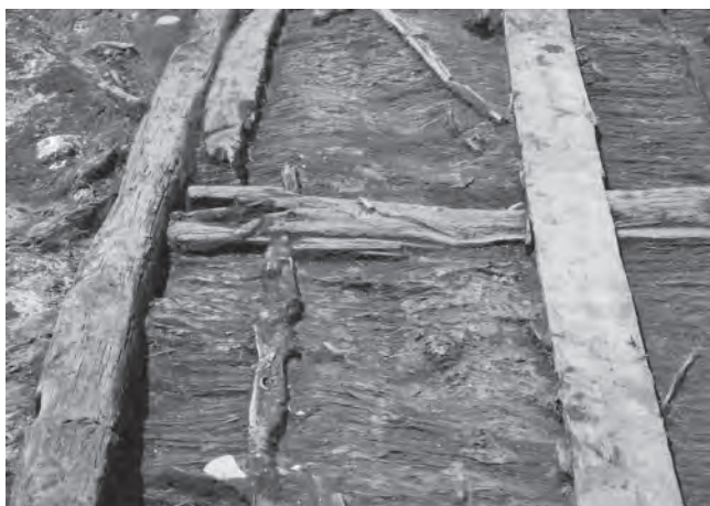
⑮ 材4 破断状況
