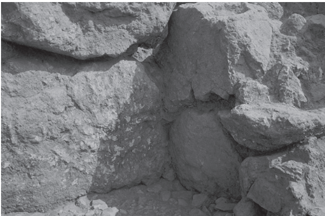
3 2号墳 石室 奥壁と東側壁の接地状況 (南西→)
