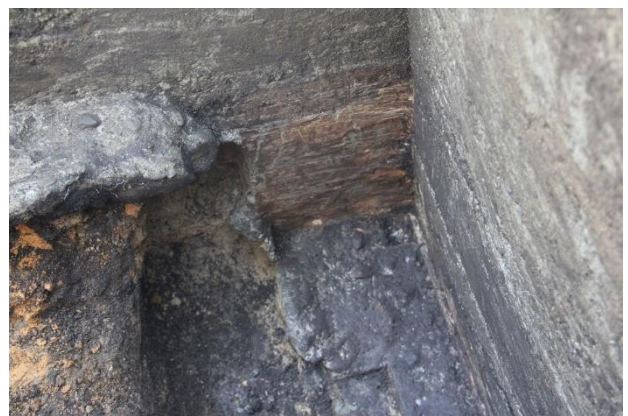
④ 4号掩体壕第1トレンチ状況 擁壁基礎最深部への杉板表面付着の状況
