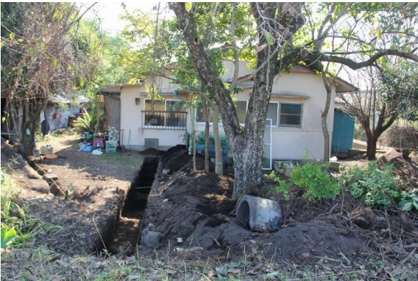
③ 3号掩体壕第4トレンチ状況 掩体後室側より中央部の掘り下げ状況を見る
