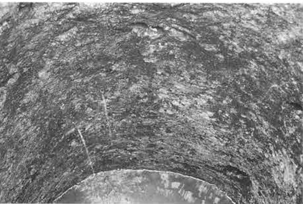
井1の水吹き出し状態 東から
