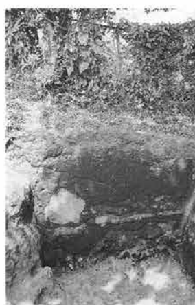
⑧円弧崩れ（東より）
