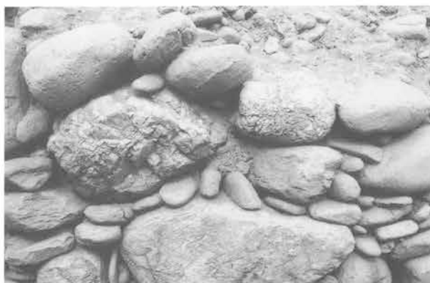
4 石室石材の割れ
