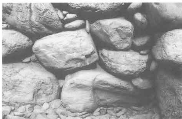
2 石室石材の割れ
