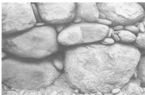
3 石室石材の割れ
