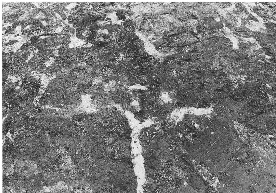
No 7 エリアHr-FA下地割れ
