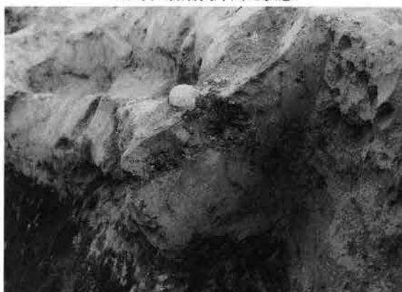
41号住居南壁クラック断ち割り
