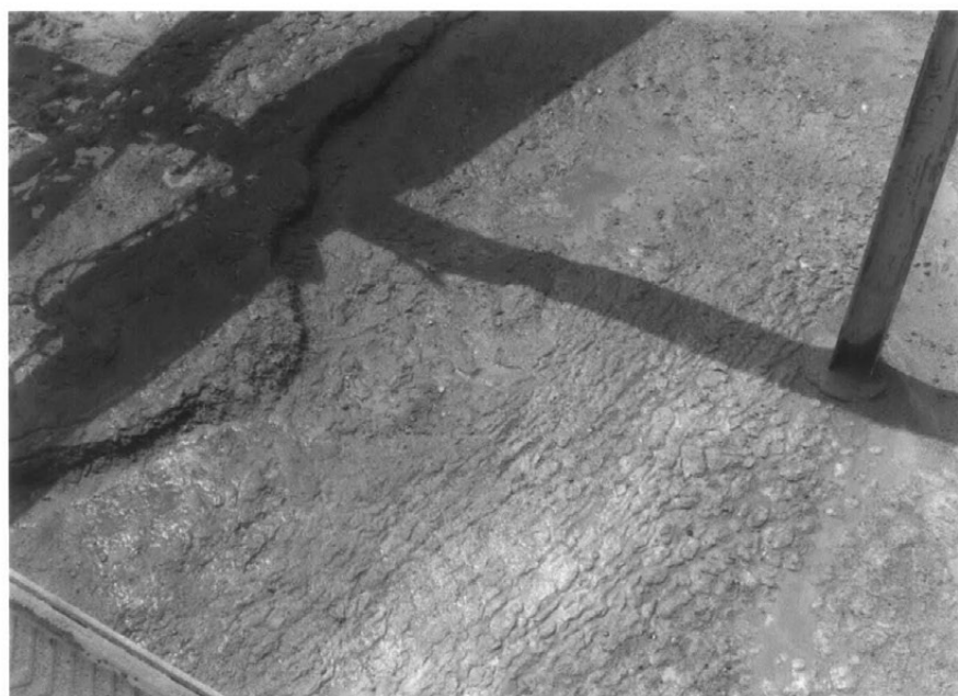
NR1301底面の 侵食痕跡(1) (北西から)
