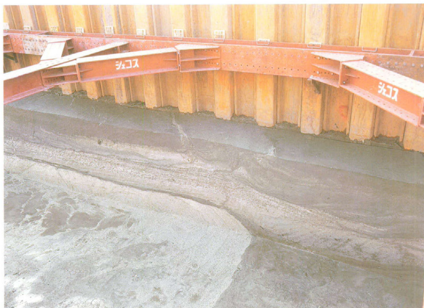
第4層の噴砂・亀裂 (北東から)
