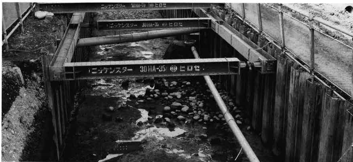
3 南辺推定第3張出部の石垣崩落の状態（1区東、南より）
