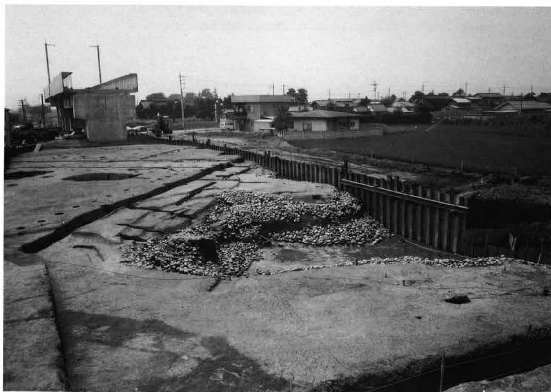
2 館西辺石垣の崩落状態（北東より）
