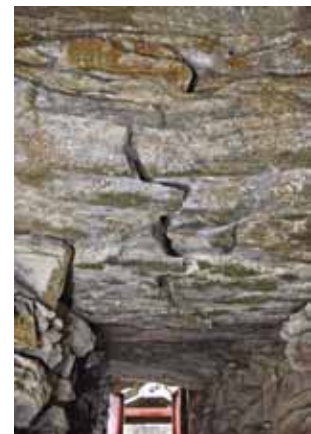
玄室前道天井石の割れ
