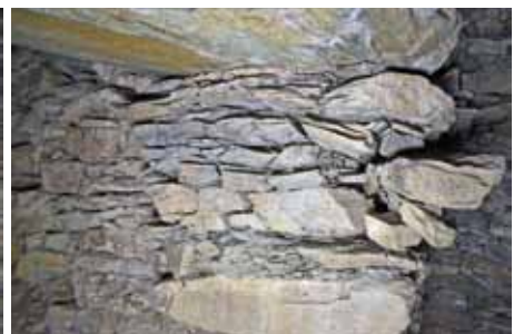
玄室前道袖石の割れ
