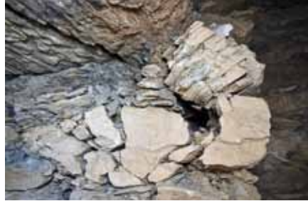
玄室前道袖石の割れ
