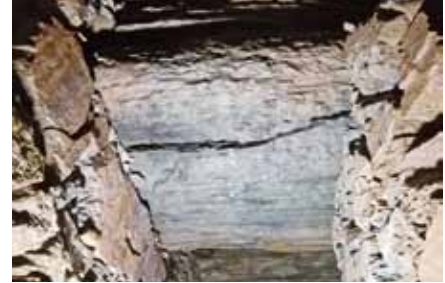
玄室前道天井石の割れ
