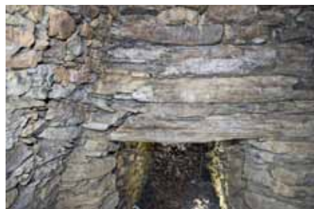
玄室前道天井石の割れ
