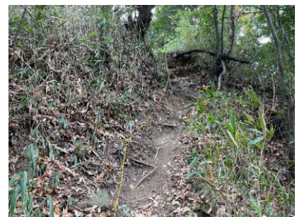
図 136 土砂流出の進む登山道
