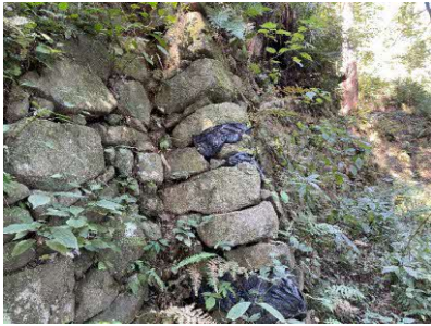
図 119 一部の石材が散失した石垣(石垣 69)
