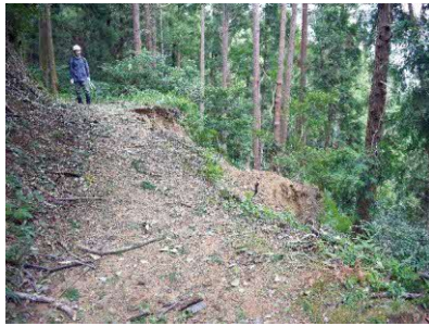
図 123 崩壊した曲輪法面
