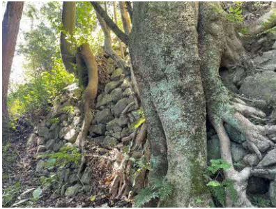
図 122 石垣面に樹木が生育している石垣(石垣 69)
