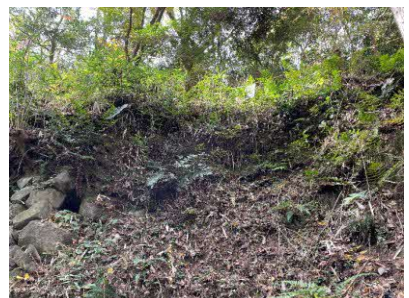
図 127 土砂流出発生箇所(石垣 69)
