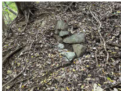
図 117 ほとんど残存していない 石垣(石垣 27)
