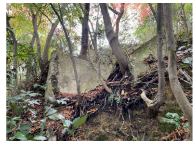
図 151 史跡指定地内にある擁壁
