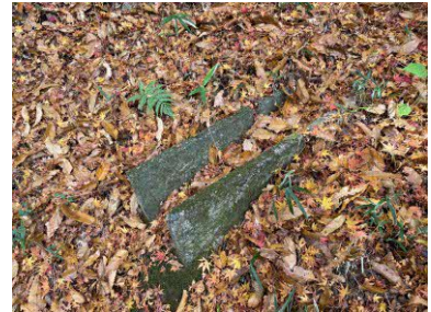
図 152 排水機能のないU字側溝
