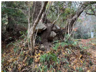
図 116 ほぼ崩壊している石垣 (石垣 71)
