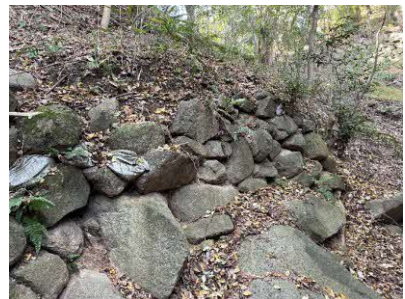
図 118 崩壊が進んでいる石垣 (石垣 89)
