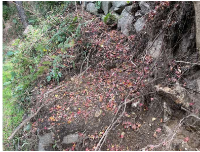
図 120 獣害により土砂が流出した石垣(石垣 6・7)
