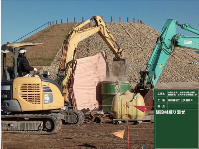
R1 園路舗装工 段築テラス (小段) 土質舗装 舗設材練混ぜ
