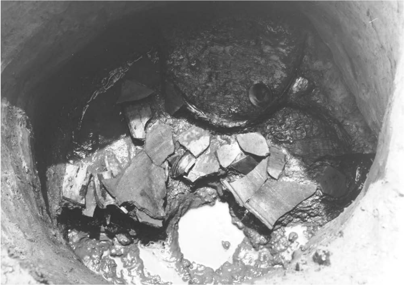
井戸No. 4-857 (南西)
