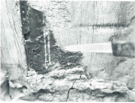
剥離箇所を膠水含浸
