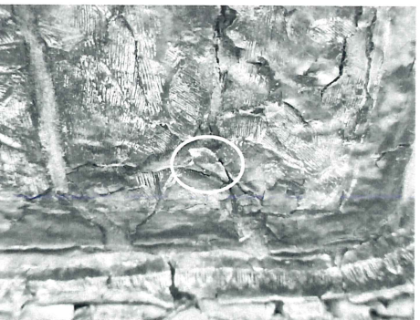
剥落箇所が判明した塗膜片
