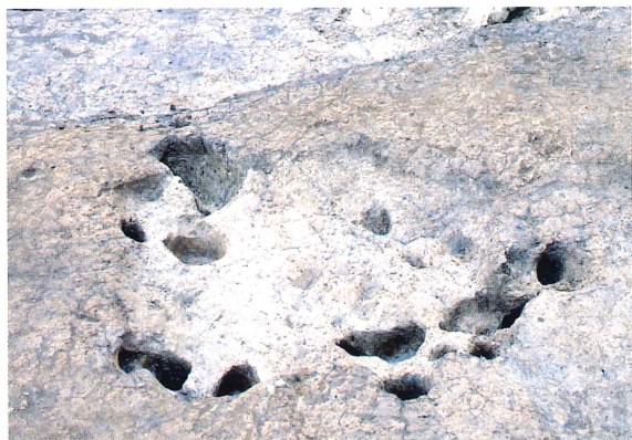
SH03 中央付近の凹みの様子
