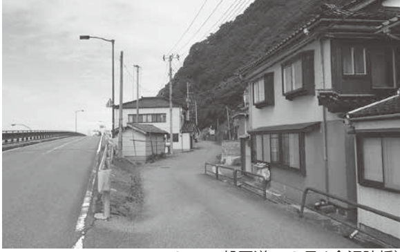
31 一般国道 112 号 (金沢陸橋) 橋梁撤去・道路改良工事 (南西から)
