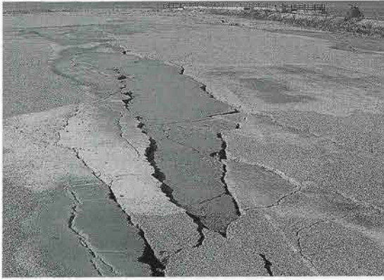
写真3 西宮市内の海岸に沿って生じた地割れ群 (地割れの一部から噴砂が流れ出している)
