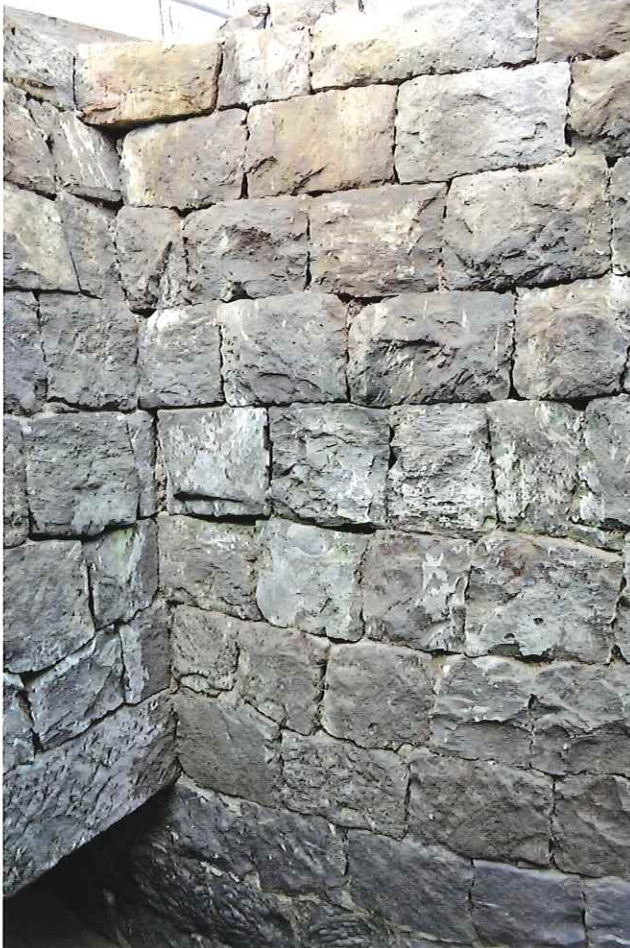
1号用水路南端部東壁面①
