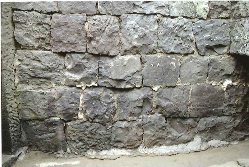
1号水路南端部西壁面下部
