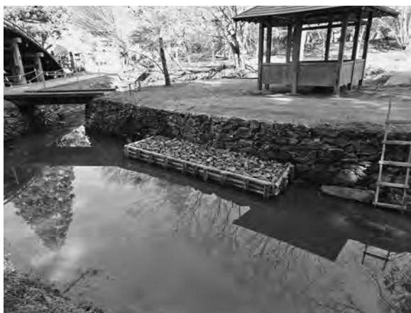
図2 丹生都比売神社 崩落した東池石垣の修理
