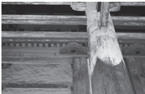
Fig.VIII-3-14 東大寺南大門 下層の藁座 (北から)
