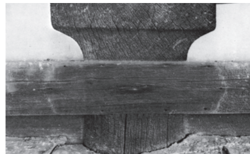
Fig.VI-8-4 薬師寺東塔 台輪金具の当たり痕跡
