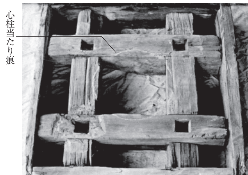
Fig.VI-4-17 海住山寺五重塔 露盤井桁杵下面の心柱当たり痕
