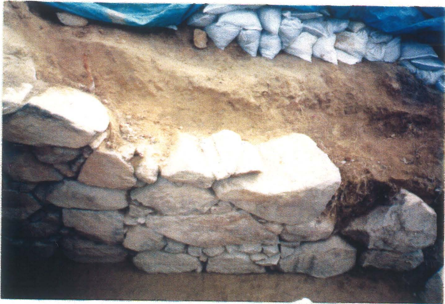
同羨道部崩落状況（西から）
