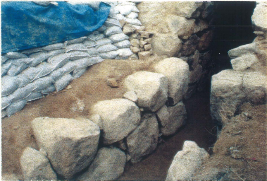
同羨道部崩落状況（南東から）
