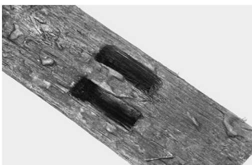
図112 土居桁（南側）下面のエツリ穴
