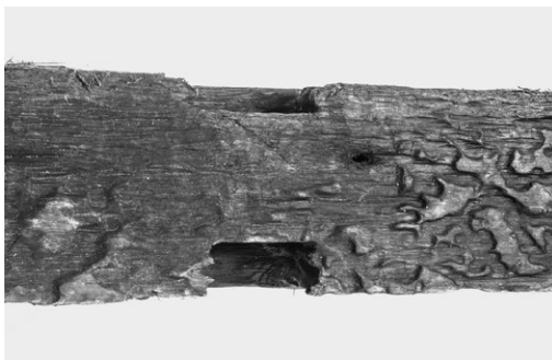
図110 土居桁（西側）下面の欠込
