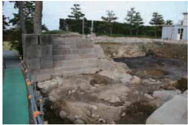
3240W(北側石垣台西面)・SX026(東側頬当石垣階段)・ 3241(東側頬当石垣) 南西から
