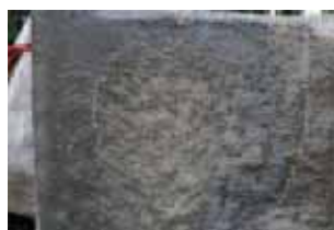
煤が付着した側面
