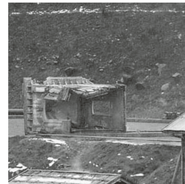
転倒している制水井上家（大正7年）
