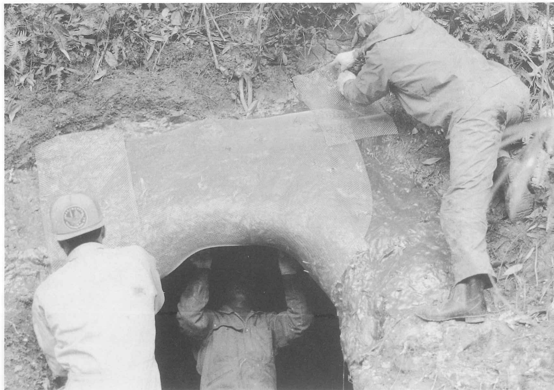
図版16 14号横穴「発泡ウレタン被覆FRP貼り付け後のステンレス金網取付け」
