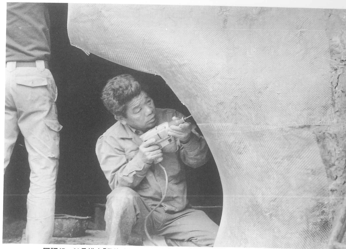
図版45 69号横穴「発泡ウレタン被覆FRP貼り付け後のステンレス金網取付け」
