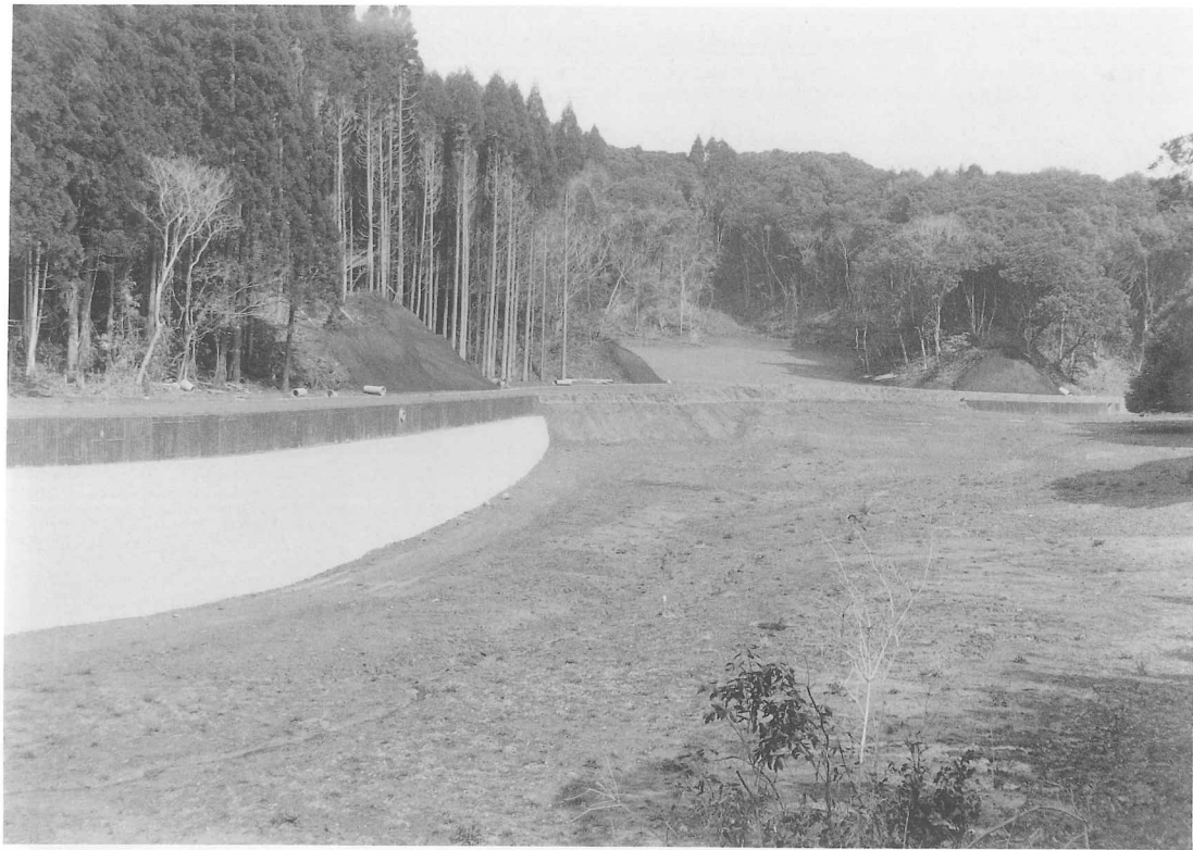
図版89 稲荷池西岸見学道築造及び奥部広場造成工事(南より望む)
