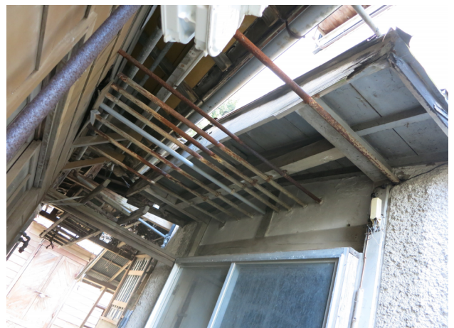
電気室から当初建物への引込電源 当時大容量の引込をしていた
