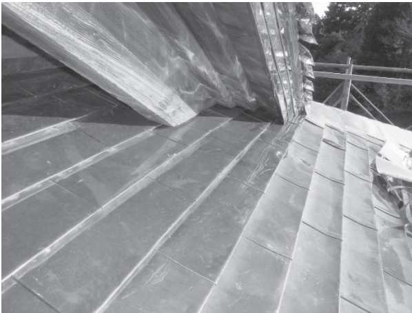
・「離れ」2階銅板平葺き屋根 銅板重ねの先端を箆で浮かせ、桧皮葺きの質感を出す工法を採用。施工業者は限られる。
