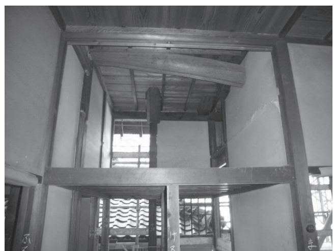
・同2階納戸：鴨居上方の柱に旧天井廻縁欠込み。 右壁の上方同位置に塗り違い傷。後補工事？
