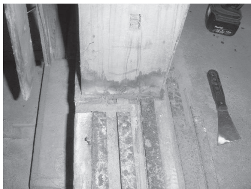
・3本敷居と柱「ぬ-7」：錆びた鉄板。外部の一筋敷居(雨戸用)の樋端にも鉄板が見える。
