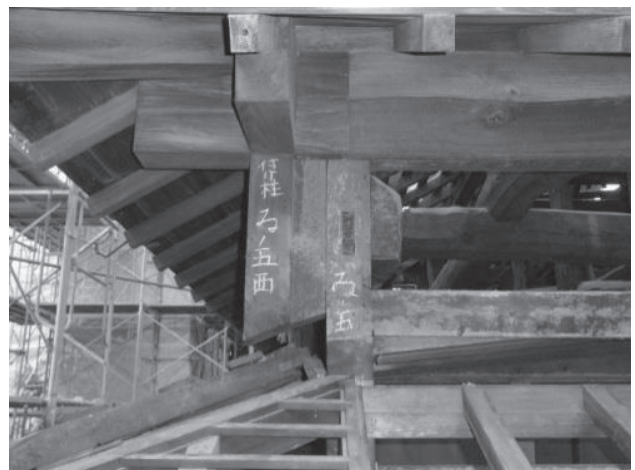
・西縁側 3 ：「ゐ-5」が柱筋であり「ゐ-5 西」の付柱が軒桁を受ける。7.5 寸（＝152 mm）の移動は次ページ上の写真に見える葺き巾の狭い背面側へ下る屋根面の処理であろう。隅棟と谷の脇瓦は斜に切り込む事が必須であり、安定しない。
