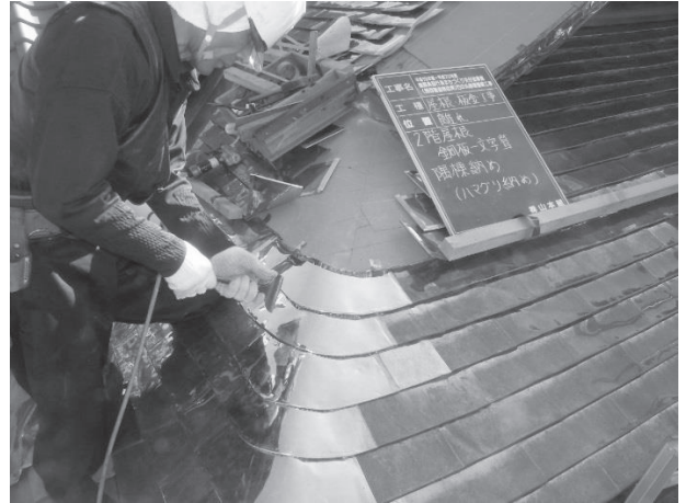
・「離れ」2階屋根隅棟： 旧桧皮葺屋根を摸倣して銅板平葺き施工。 隅棟は桧皮葺きに似せた丸みを付けた蛤型。
