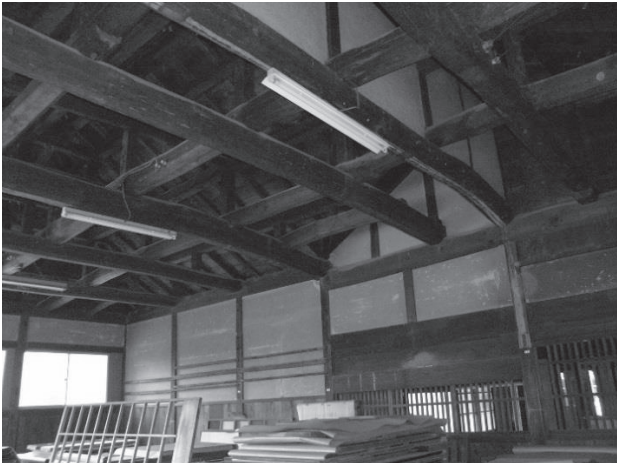
・作業場棟内部：作業場右奥隅から 壁は黄大津壁。天井は張られていない。 腰壁の上は黄大津鍍塗り壁。
