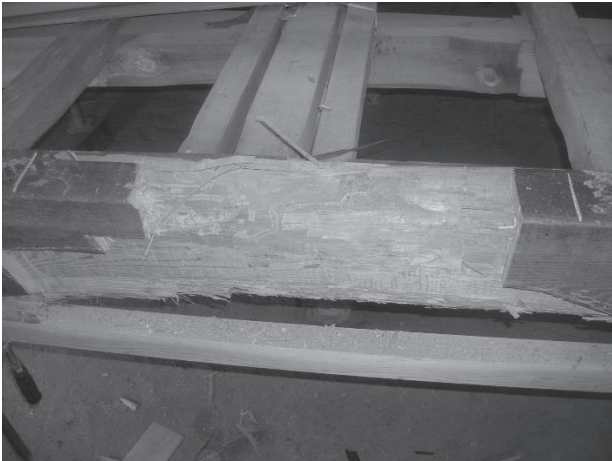
・ 蟻害を受けた台所・ひろま境板間上框の修理 1 材種は松。取り外して被害量を確認。被害箇所を荒取りする。
