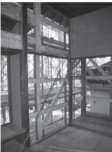
・「離れ」2階控えの間：柱が真近に2本並ぶ？ 右の柱は半柱に欠取られている。後補工事？
