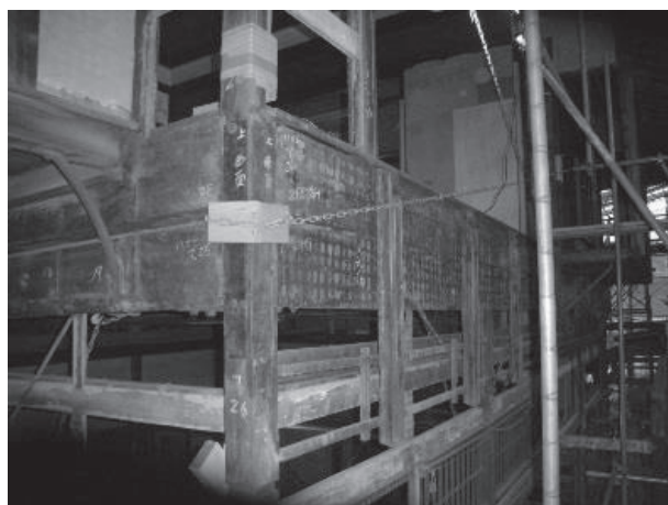
・柱「て-26」の1、2階の繋ぎ：下側の柱は平角材=軒桁の下で切れ、2階の柱の半分であろう部分が、その柱に乗る。一方、軒桁は2階柱の最下部を欠き込んで密着されている。上側の2方向の平角材は2階柱に留まる。この側面にL型金属板がボルト止めで施され、縦横4材を固定する。
