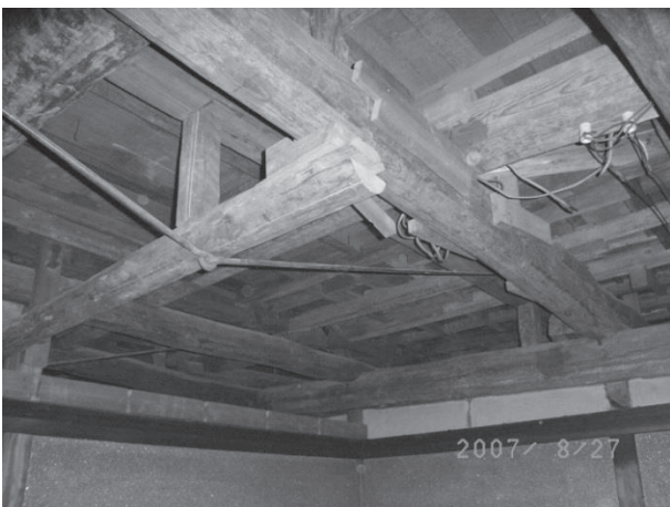
・「離れ」1階座敷天井裏：平屋時の小屋梁と2階床梁、それを補強する梁、と3重に梁が架かる部分も見える。鉄筋の補強もある。
