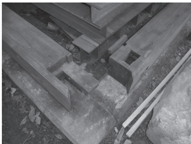
・作業場棟「いー1」土台隅
