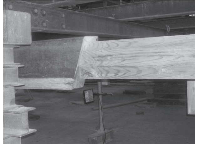
・ 蟻害を受けた台所・ひろま境板間上框の修理 2 被害箇所が確定後、補修方法を検討。その方法に合わせて元材を成型する。
