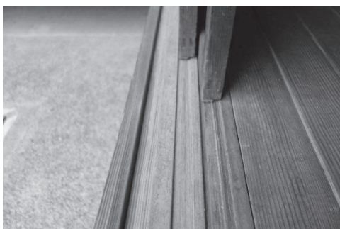
・主屋棟西縁先敷居：溝を建具が移動。
