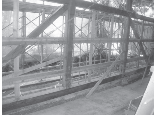
・作業場棟：1通り、この部分のみに筋違が施工されていた。比較資料がなく、竣工時施工か、後補か不明。この場合は現状に従う。
