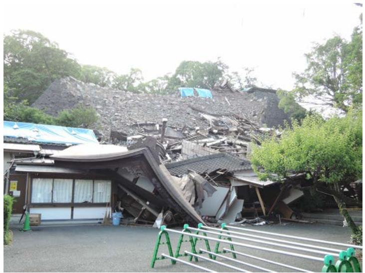
第 137 図 熊本城跡東十八間櫓台の崩壊
