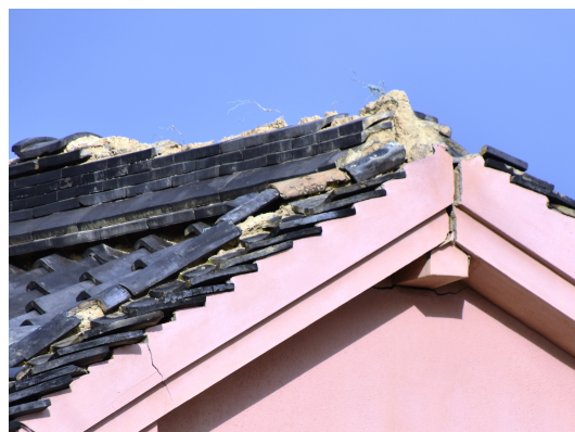
鬼瓦や棟瓦の被害
