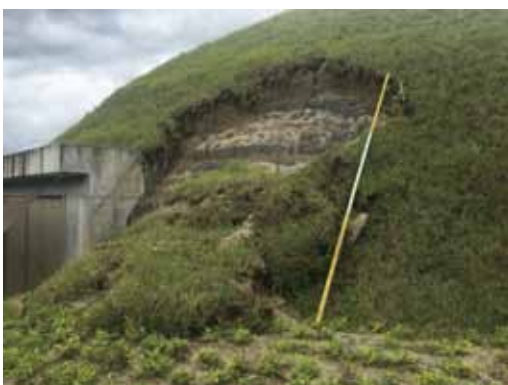
墳丘盛土流失状況
