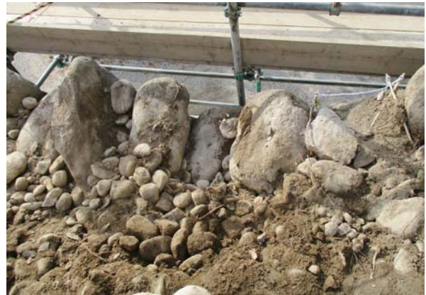
④裏込め石や築石の間に土が流入している
