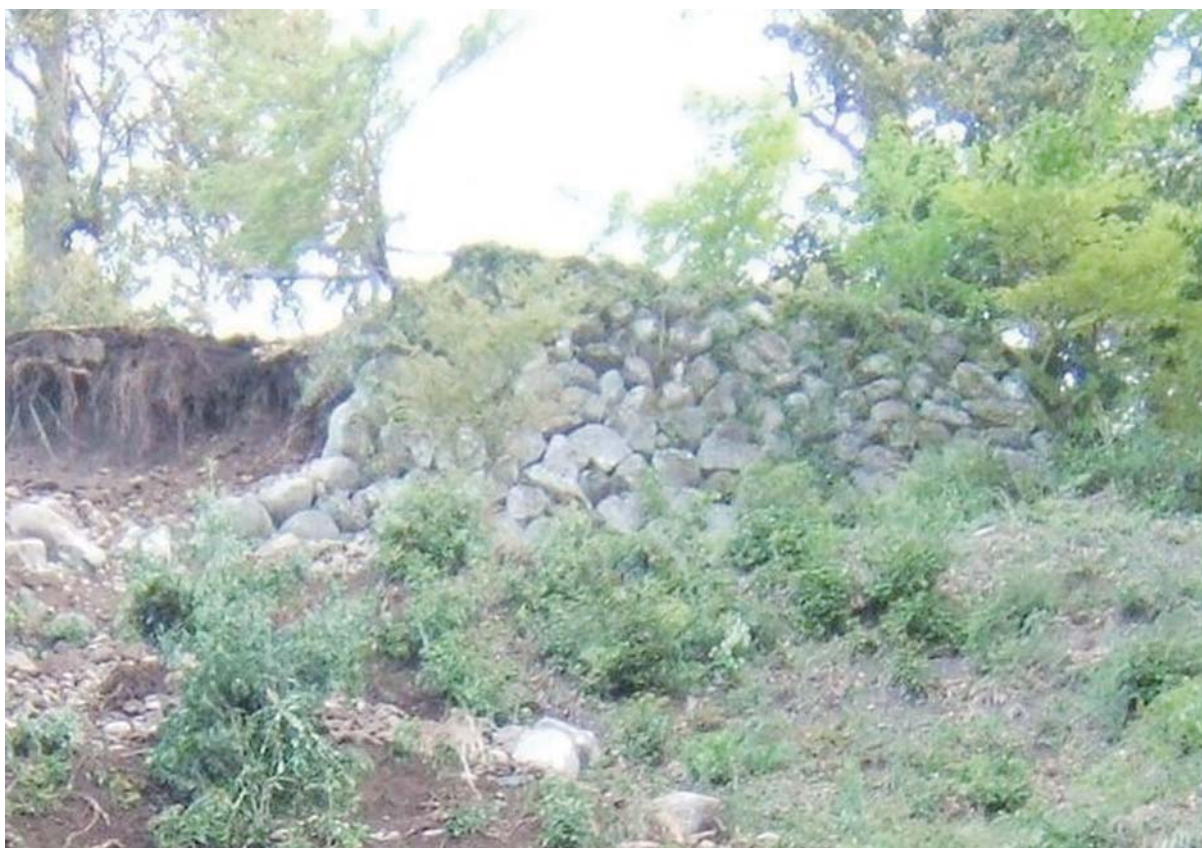
②石垣 10 被災状況
