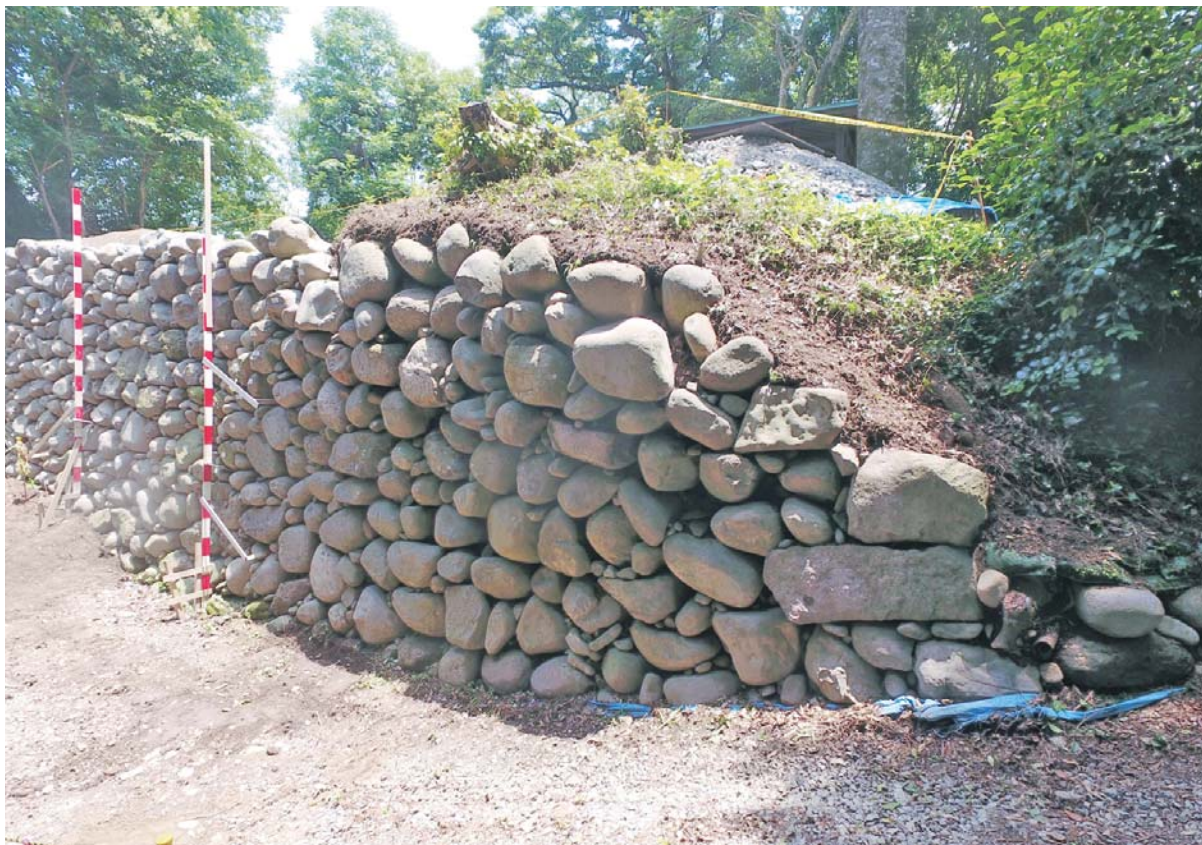
①石垣 2-2 解体前孕み状況
