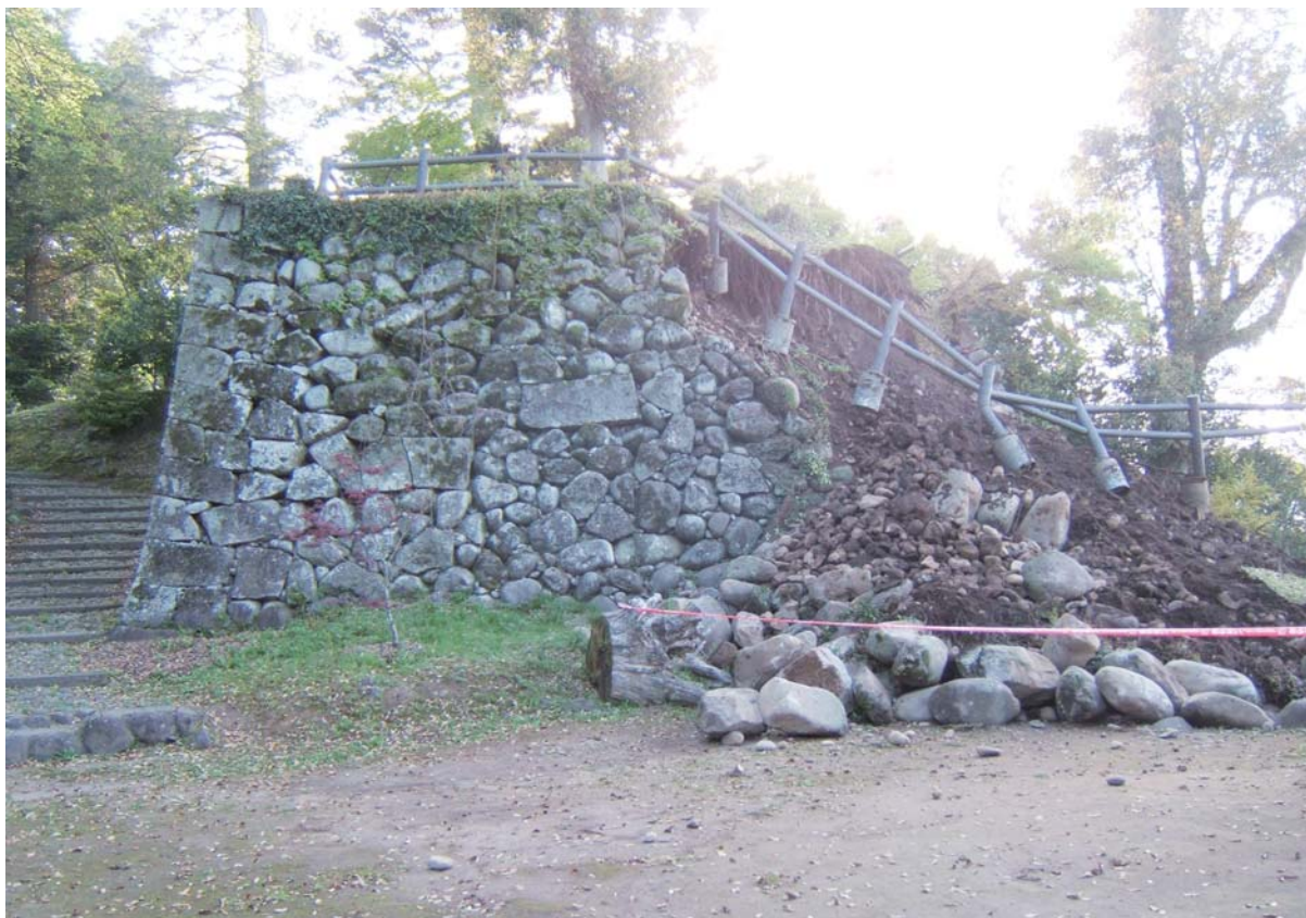
②石垣 被災状況
