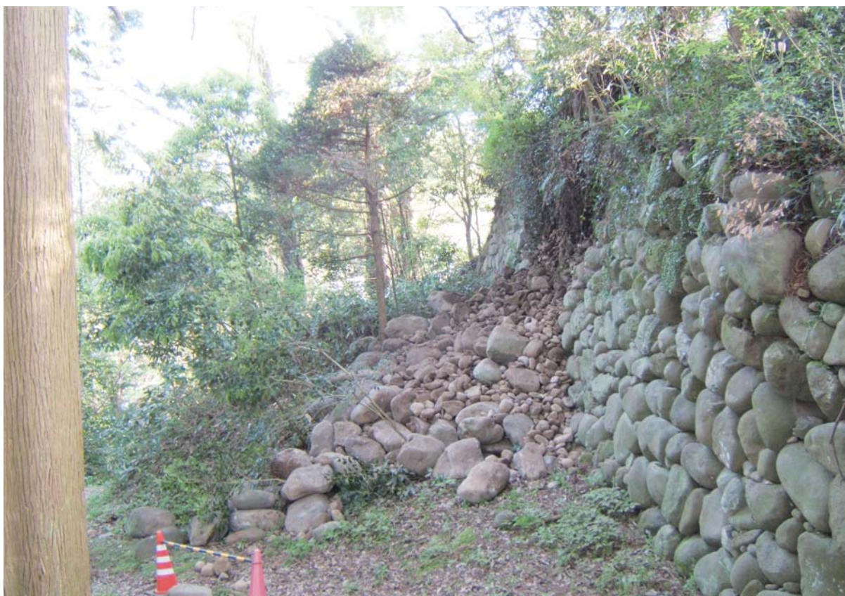
②石垣2 被災状況
