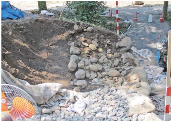
①裏止め石 2工区ほどしっかりしていない
