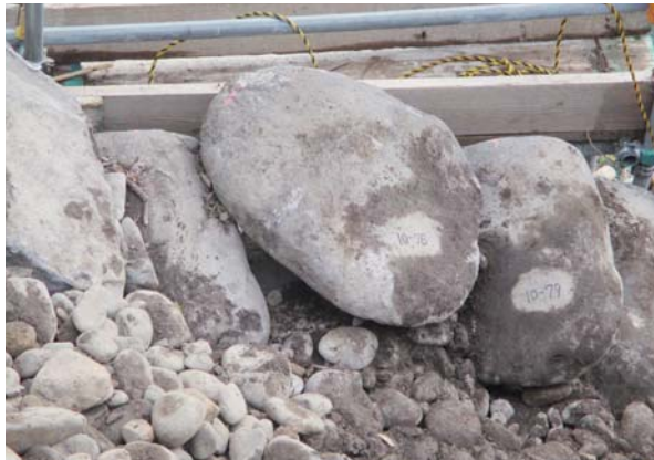
③不安定な積み方になっていた築石（10-76）
