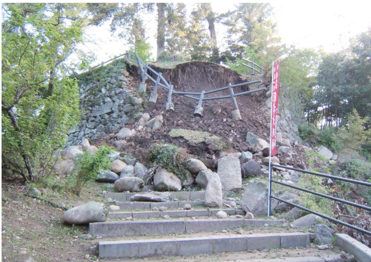
②石垣 9・10 出角部 被災状況
