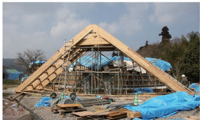
相互に支えあうまでは屋根材の崩落を防ぐために内部から支える 必要があり、完了後の撤去が容易な木材で支えを作成した。
