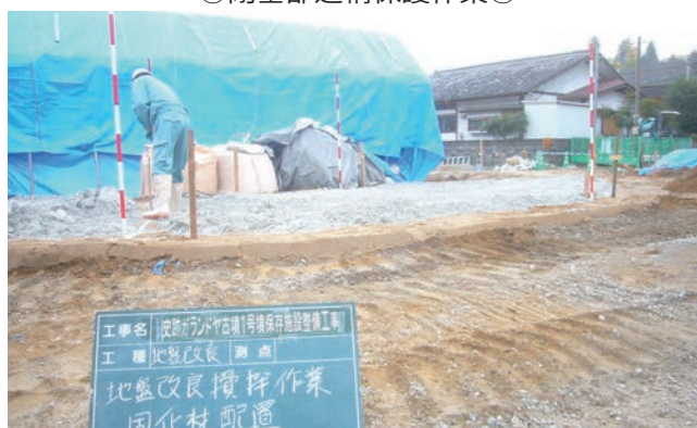
地盤改良範囲に改良材（セメント系固化材）を 120 kg / m 2 散布
