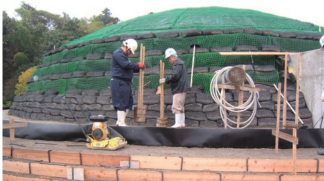
大型重機による転圧では地盤沈下を起こす恐れから、実証実験で採用した方法でバラツキがないように実施した。
