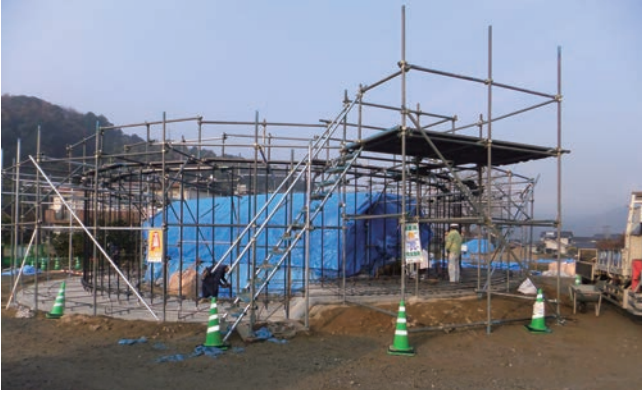
PC 鋼は 40 cm ピッチで壁中心に設置し、基礎・壁・屋根を一体にする。
