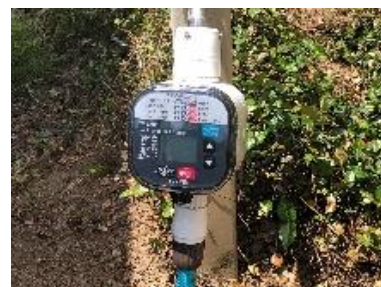
水やりタイマーの設置
