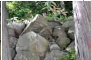
天端付近の迫出し
