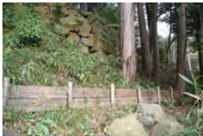
1641S前面の転落石材
