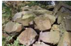
大きく迫出した石材
