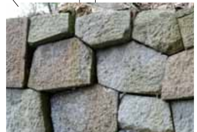
石が迫出し、石面が大きく乱れる
