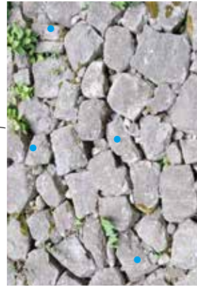
石積み下半部に割れが集中する傾向
