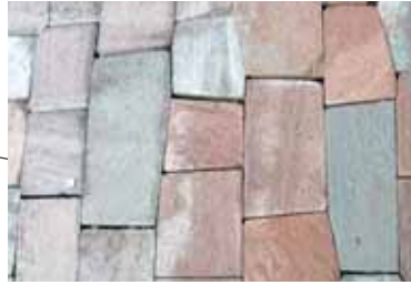
孕み出し箇所縦方向の連続した目地の開き
