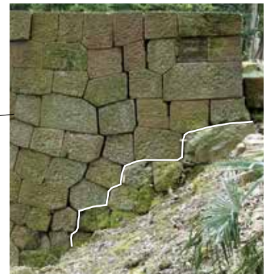
縦方向の連続した目地の開き (1~4.3cm) 2830Nと異なり、築石部にも及ぶ 最下部に江戸後期修築前の石積み
