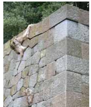
天端等の石面が乱れ、樹木根が築石の目地に入り込む
