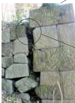
隅角部と築石間に縦方向の目地が開く (15~20cm)
