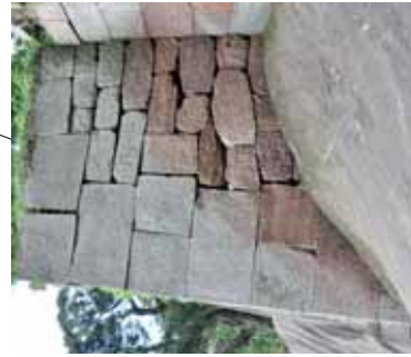
隅角部と築石間に縦方向の連続した目地の開き
