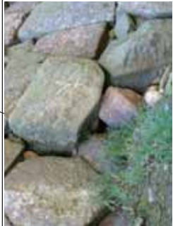
最下段の石は面部分が欠損、前倒れ 直上の石材が前へ追出す
