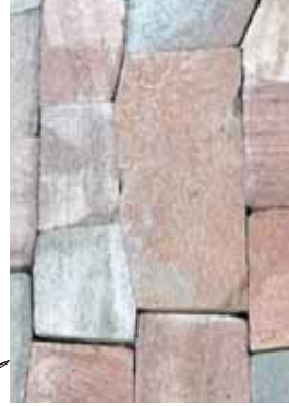
石面縁部の角欠け
