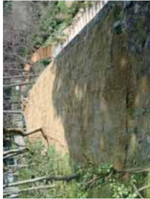
砂及びその上面に芝生を敷設し、浸食防止の措置をとる（修景後）
