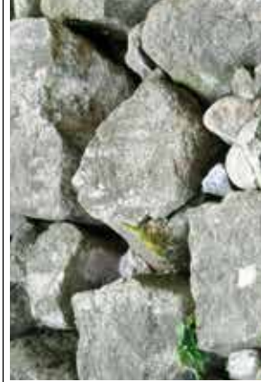
孕み出し直下の石材の胸割れ
