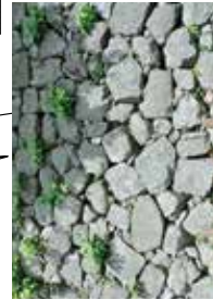
石材の割れが集中
