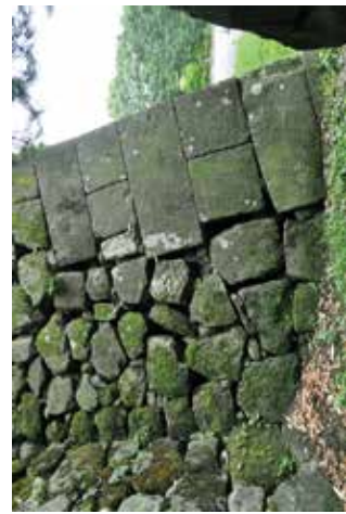
隅角部と築石部に縦方向の開き
