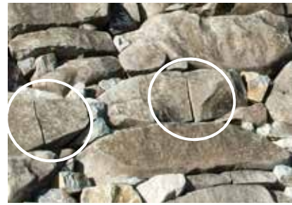
写真11 積み石の曲げ破壊の例
