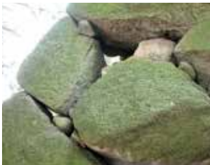
隅角部の変形状況
