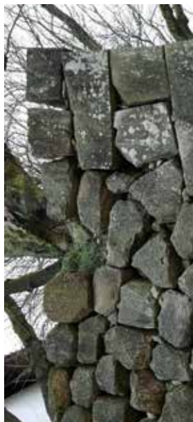
天端角石の迫出しと抜け落ち
