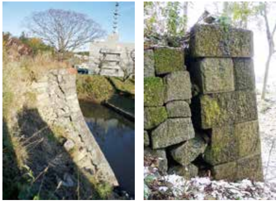
(a) 地震による前倒れ (b) 地盤の変状による前倒れ 写真17 出隅部石垣の前倒れ変形の例
