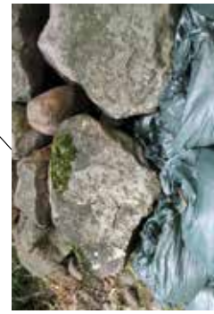
前方の盛土が流出し、根石が浮いた状態。土壌による養生
