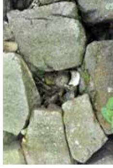
築石部の石口の開き、裏込めが表出
