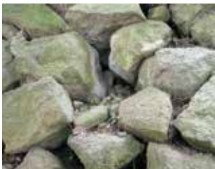
築石部の裏込めが流出
