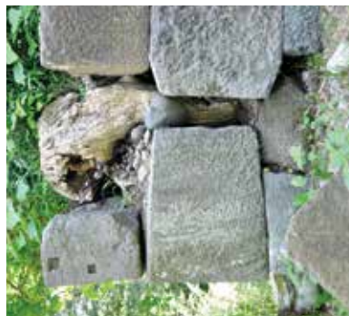
天端角石の前倒れと角脇石の崩落。その背後に樹木根 (枯) が遺存
