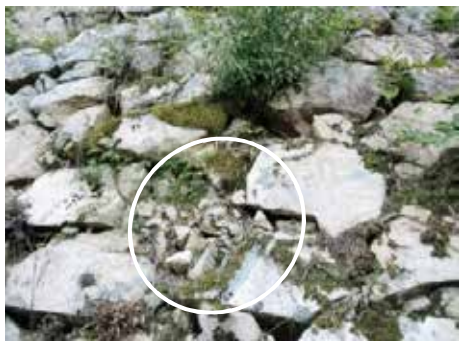
写真13 積み石の圧壊（せん断破壊）の例
