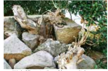
樹木根による石積み目の乱れ
