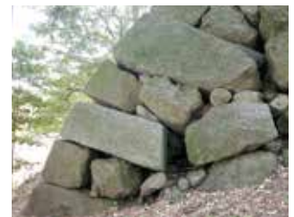
詰石の抜け等、石口が大きく開く
