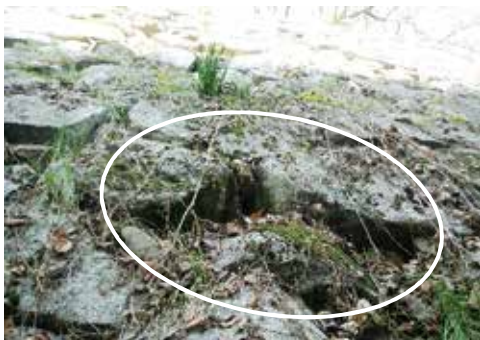
写真14 積み石の抜け落ちの例
