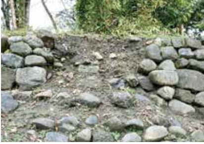
石材の崩落、雨水による背面盛土の流出
