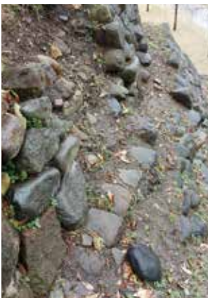
根石とみられる石列の通りから、 改修の可能性がある
