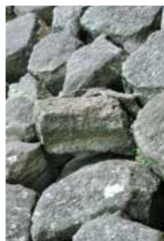
築石の割れ・迫出し
