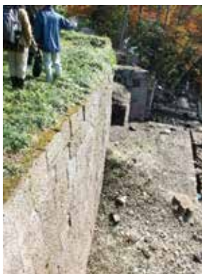
写真18 背面地盤の変状による前倒れ変形
