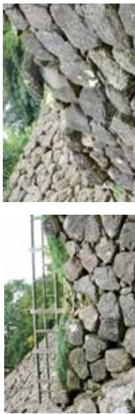
天端石の迫出し
