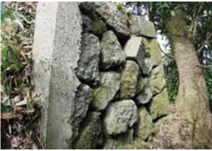
面的な前倒れや石口が開く等、全体的に変形している。特に南半部（立面図破線左側）が顕著
