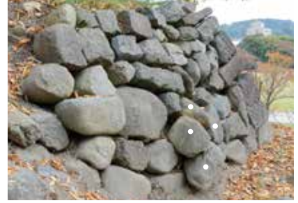
築石崩落前（西から） 築石が前に迫出し、上部からの荷重が少ない状況
