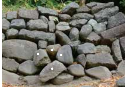
築石崩落前（北から）
