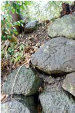
雨水により天端周辺の表土が流出
