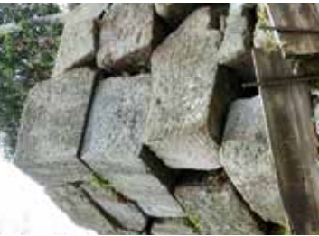
東側斜め方向に根石ごと滑り、角石のずれが生じる
