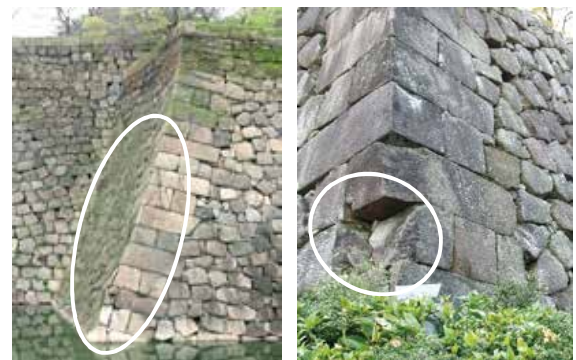
写真12 積み石の割裂破壊の例
