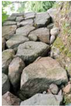
築石の前倒れ
