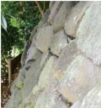
築石の迫出し、面的に前倒れした状態。さらに南側は近代以降に撤去されており、その際に変形が生じた可能性がある
