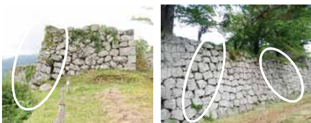
(a) 斜面滑りによる変状 (b) 地盤の沈下による変状
