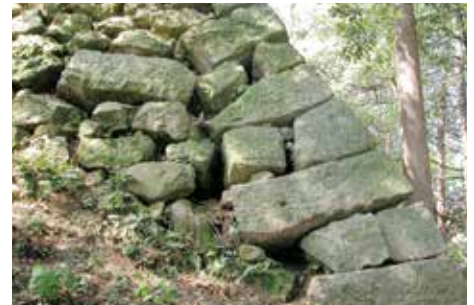
石積みの乱れと詰石の抜け
