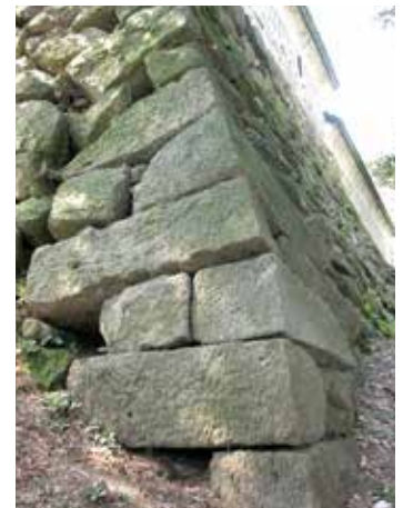
変形による稜線のずれ、斜面方向の滑りにより下部角石の石尻が上がり角度が水平
